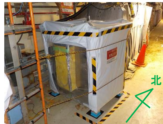
ミュオン測定装置 設置状態 (小型装置, 約1m×1m×高さ1.3m)
